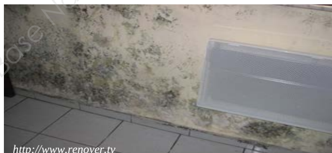
Traces sur le mur de la buanderie
