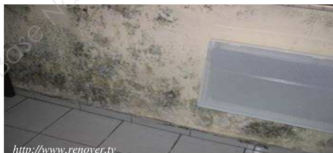
Traces sur le mur de la buanderie
